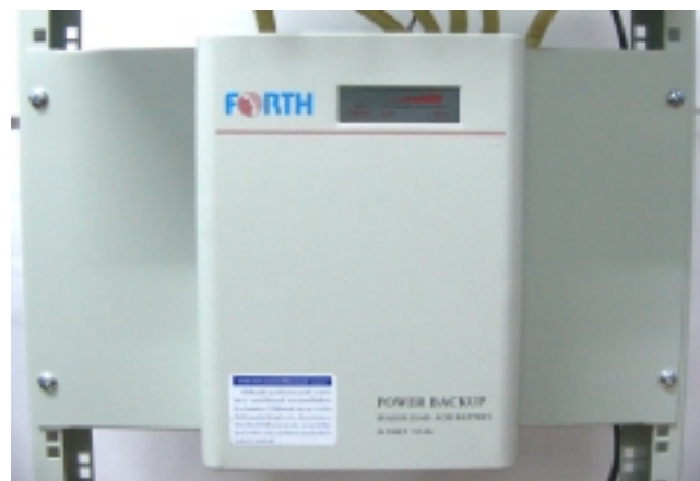
ด้านหลังแผง MDF จะติดตั้ง Battery Backup
